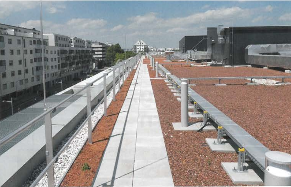
Auflastgehaltenes Geländer zur Wegführung und Sicherung bei Pflege und Wartung.
